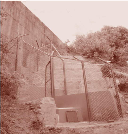
Sistema de agua en Taray, Cusco.
